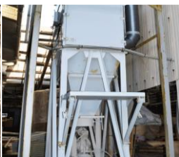
乾燥集塵機 4基
