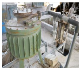
湿式除鉄機 1基
