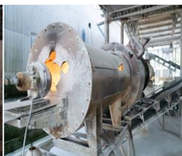
ロータリードライヤ 1基
