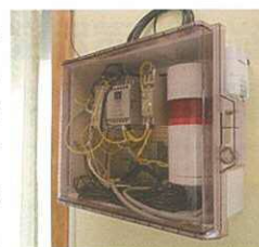
導入したアラーム設備
